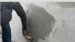
Parches de Concreto Delaminado
